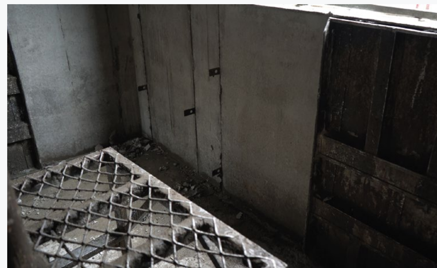
Parede parcialmente desformada
